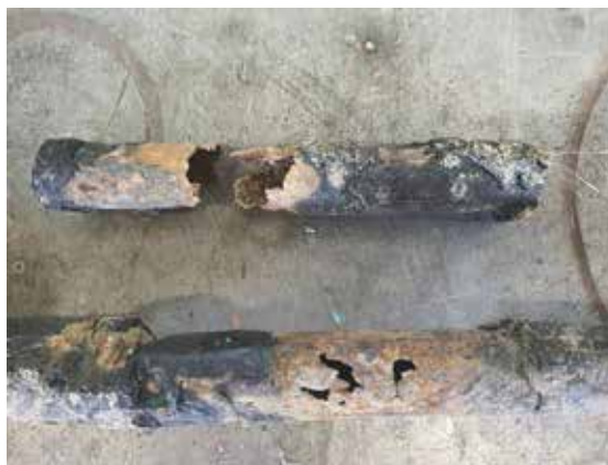
Stato dei tubi dell'acquedotto di Isera
